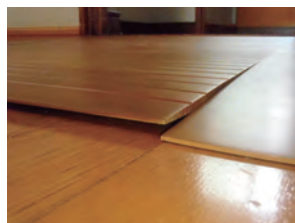
固定がされてなく変形を起こした例
